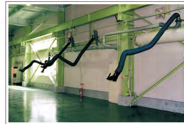
▲ 空中集中配管例
