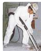
工場内の粉塵・粉体・ゴミの回収イメージ
